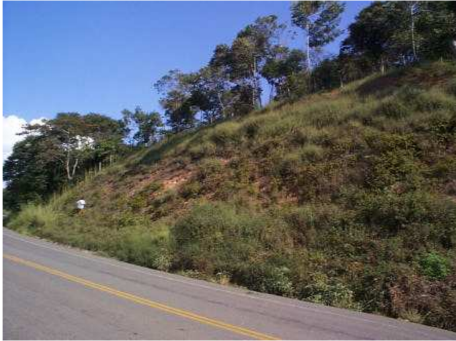
Figura 2 - Talude de Teixeira parcialmente coberto por capim-gordura ( Melinis minutiflora ) e arbustos de pixirica ( Leandra cf. nianga ) - município de Teixeira, MG.
