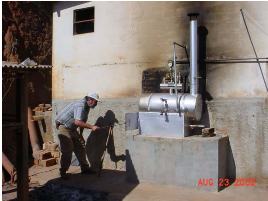
Figura 3A – Caldeira sendo abastecida.
