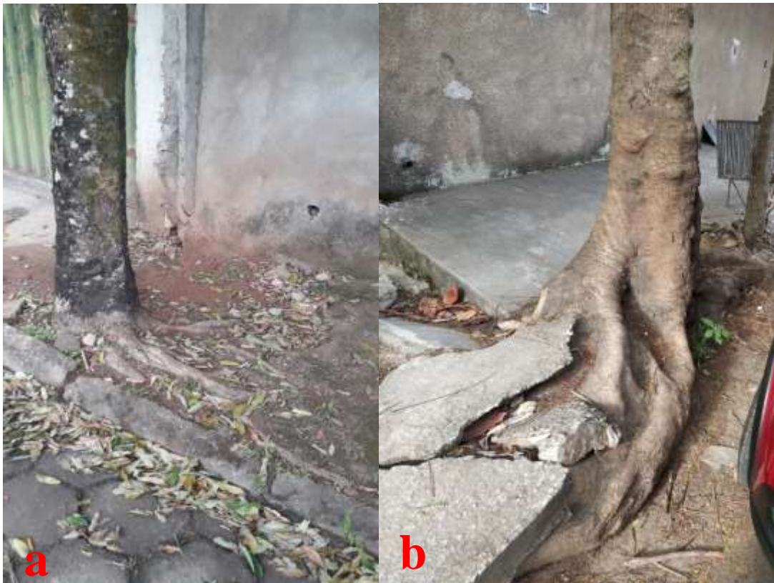
Figura 14 – Exemplos de indivíduos com problemas entre raízes e calçadas. a) classificado como raízes superficiais. b) classificado como danificando as calçadas.
