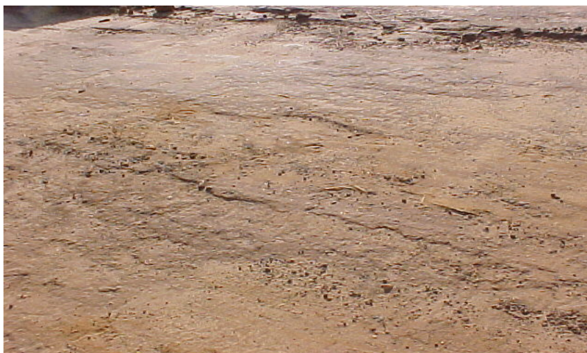
Figura 7.3 - Perda de agregado de baixo nível de severidade
