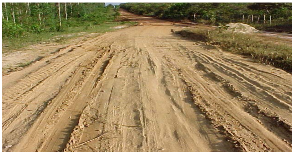
Figura 7.2 - Superposição de defeitos de médio e alto nível de severidade
