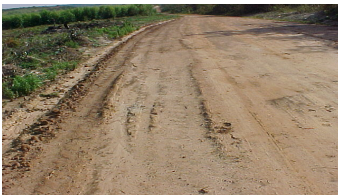
Figura 7.4 – Trilhas-de-roda de médio nível de severidade
