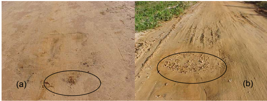
Figura 7.7 – Buracos: (a) com baixo nível de severidade e, (b) com médio nível de severidade
