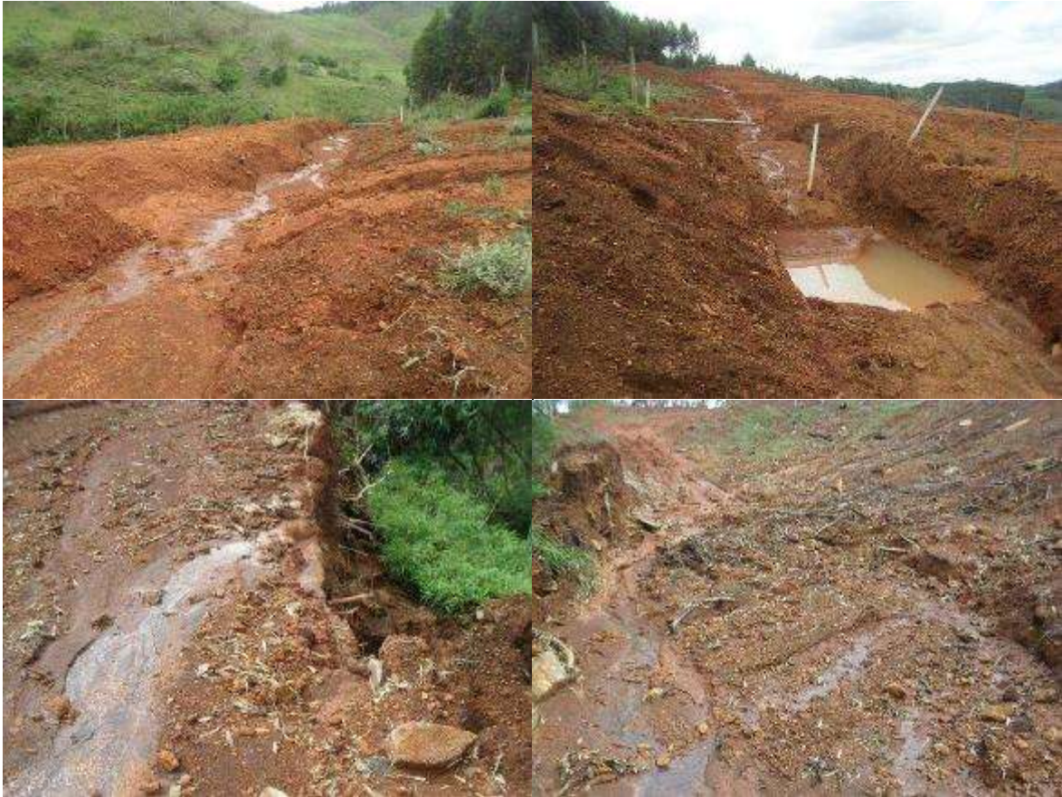
Figura 39 - Afloramento de água em áreas em reabilitação. São Sebastião da Vargem AlegreMG,2017.
