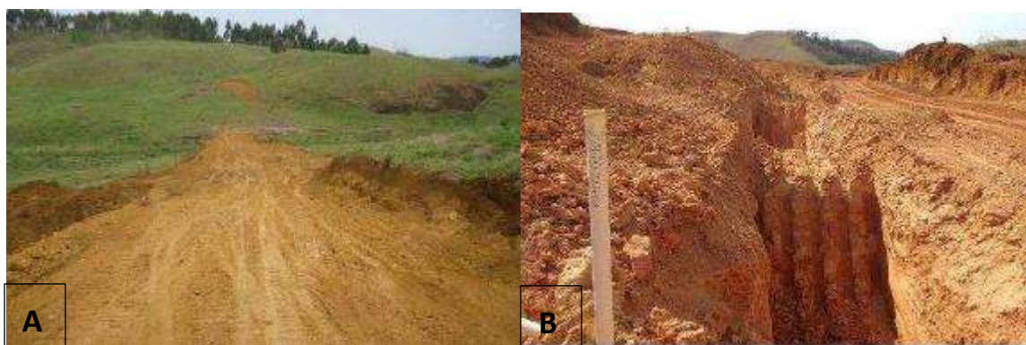
Figura 9 - Etapas da exploração da bauxita. A) Abertura de acessos. B) Poço de decantação. Mirai-MG, 2016. Foto CBA.
