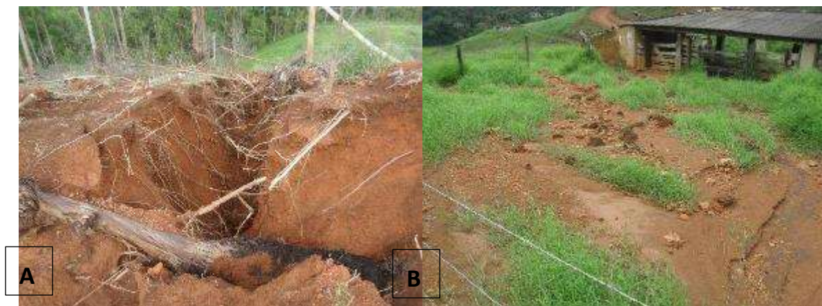
Figura 37 - Problemas em áreas de reabilitação A) Erosão em voçoroca e B) acúmulo de sedimentos em áreas em reabilitação. São Sebastião da Vargem Alegre-MG, 2017.
