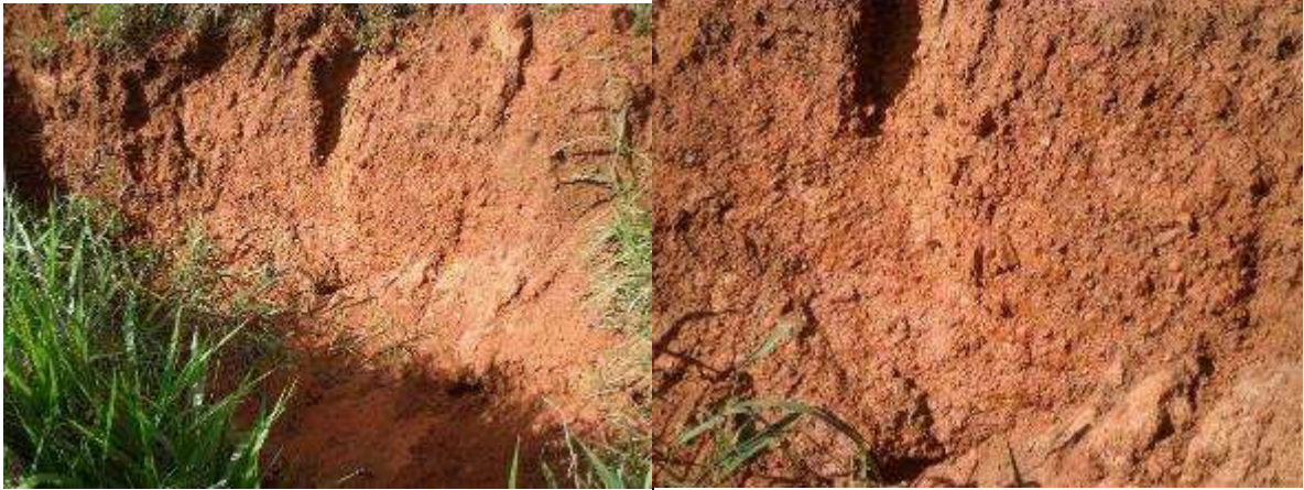
Figura 45 - Parede de um poço de decantação com elevada umidade do solo. Rosário da Limeira-MG, 2017.
