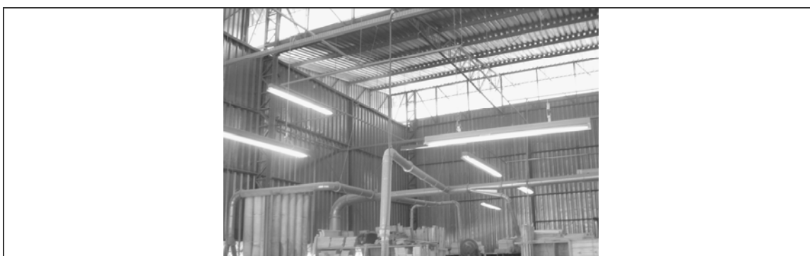
Figura 53 - Luz natural proveniente dos sheds e a distribuição não uniforme das luminárias
