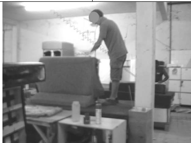
Figura 32 – Condição insegura de trabalho
