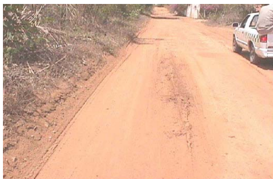
Figura 3 – Segregação e perda de agregados.
