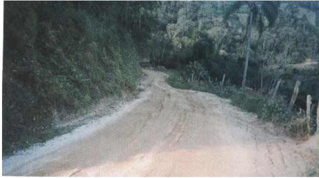
Figura 5 – Seção transversal inadequada.
