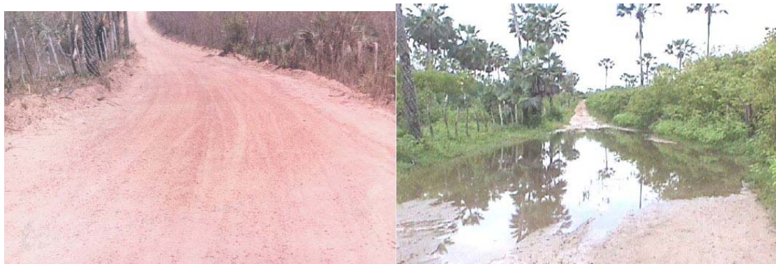
Figura 7 – Drenagem ineficiente no período de seca e chuva respectivamente. Fonte: (MOREIRA, 2003).
