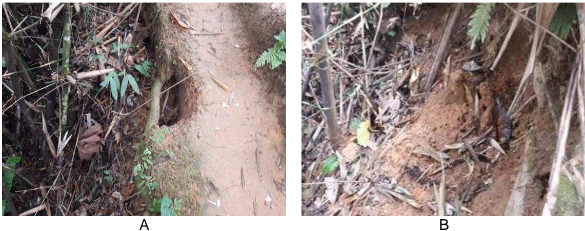
Figura 11 – Erosão. Em A: Local onde a trilha está comprometida devido ao efeito dos processos erosivos; Em B: Local com deslizamento de terra.
