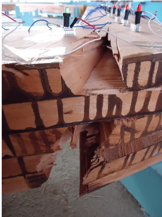
Figura 43 - Detalhe da ruptura ocorrida na região do nó D da estrutura R2.
