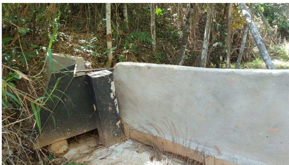
Figura 12. Vertedouro instalado a jusante da nascente na microbacia da bacia do Rio São Mateus, Itambacuri-MG, com calha tipo “H”.
