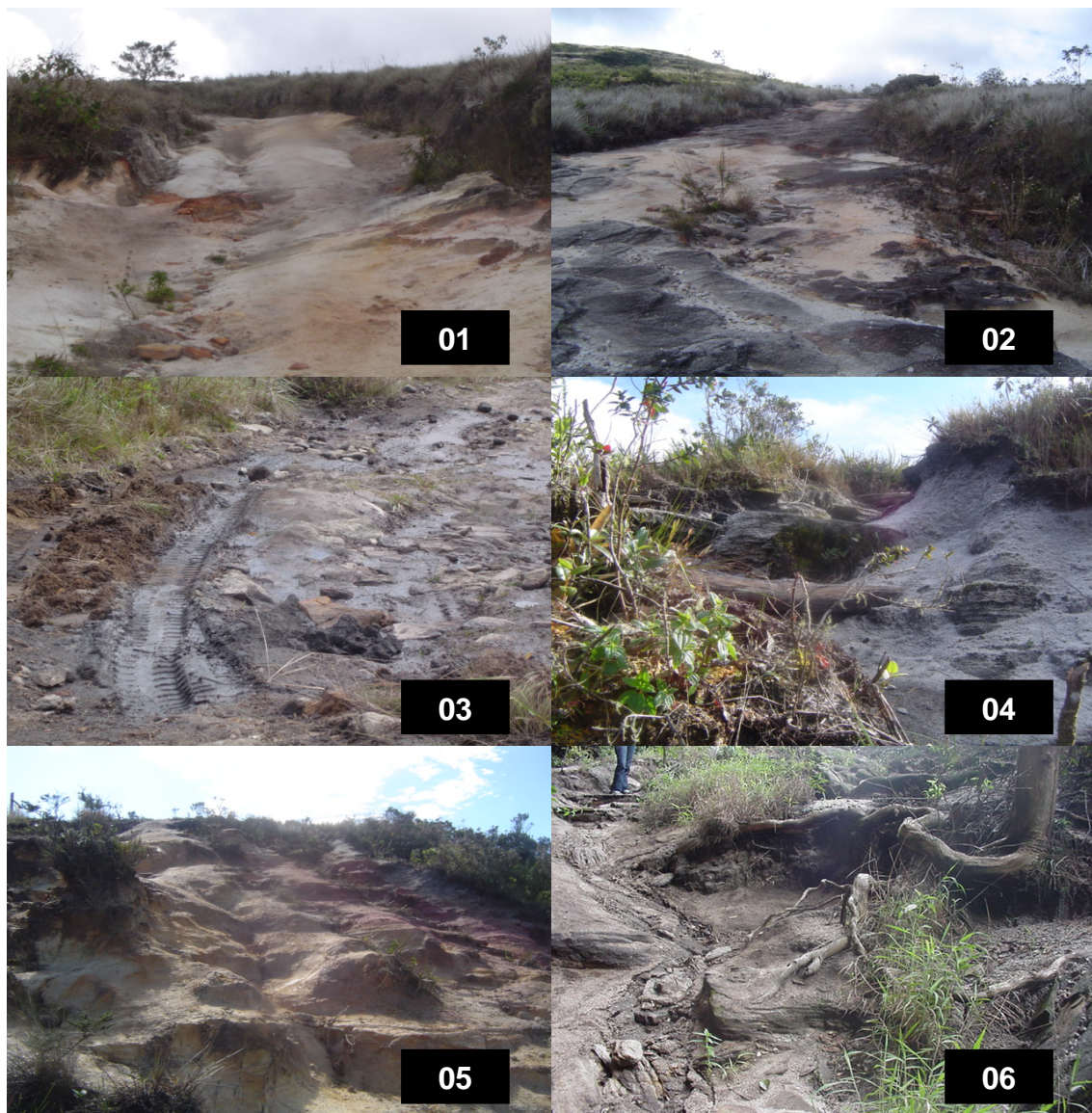
Figura 13 – Presença de focos erosivos existentes nas trilhas do PEIb, Lima Duarte, MG: roteiro Janela do Céu (01 e 02), roteiro Pico do Pião (03, 04 e 05) e roteiro Circuito das Águas (06), 2005.
