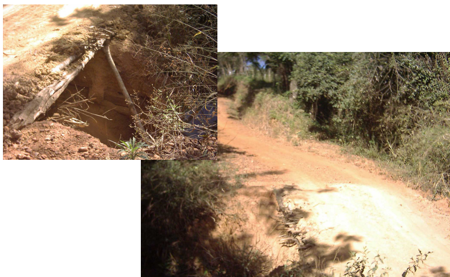
Figura 18 – Ponte improvisada, no córrego Bonito; observar a terra solta que, no período chuvoso, é carregada para o corpo d'água.
